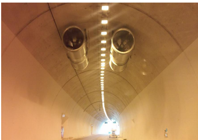
Σήραγγα Ακράτας 13A – Σύστημα εξαερισμού
